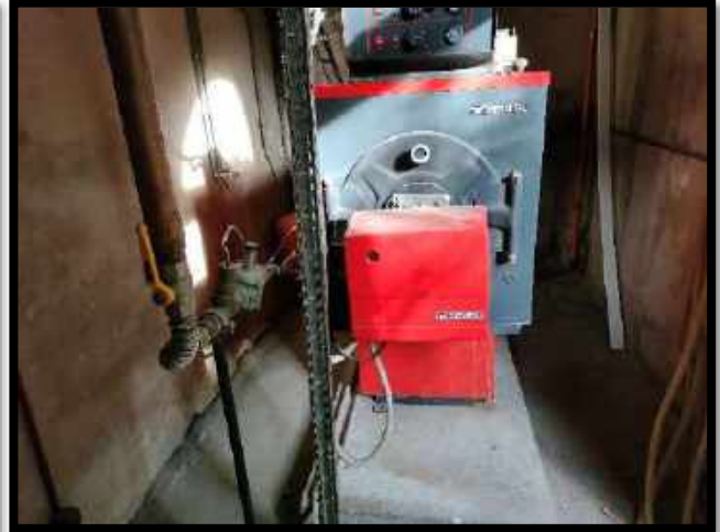
Figura 3 - Caldaia installata in centrale termica
