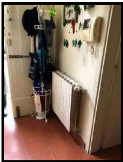
Figura 6 - Radiatore con valvola termostatica nell'alloggio del custode.
