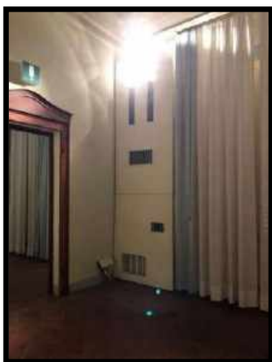
Figura 8 - Armadio condizionatore installato nella sala espositiva con cassone di copertura
