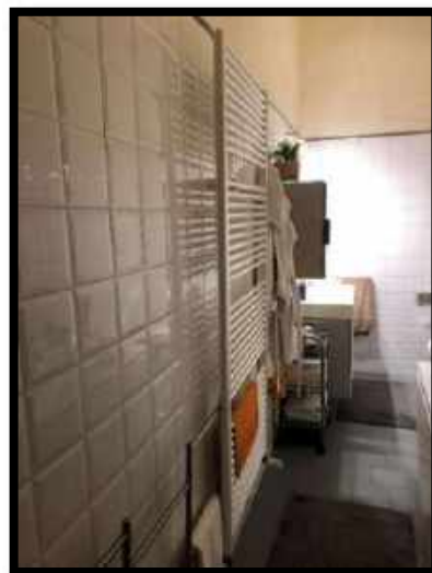
Figura 7 - Termoarredo installato nel bagno dell'alloggio del custode.
