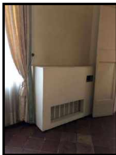
Figura 9 - Ventilconvettore installato nella sala espositiva 6 con cassone di copertura
